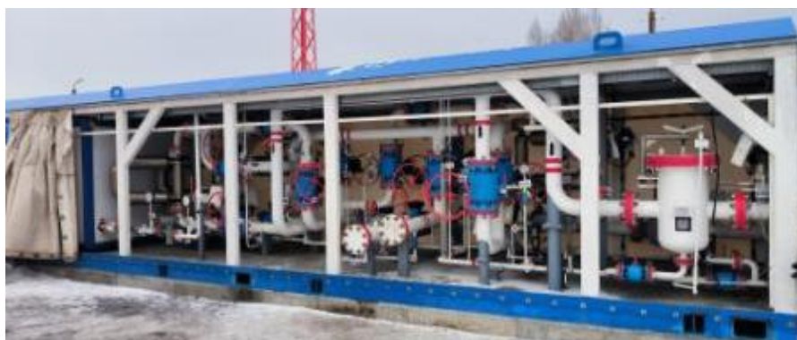
Рисунок 1 - Общий вид СИКН
