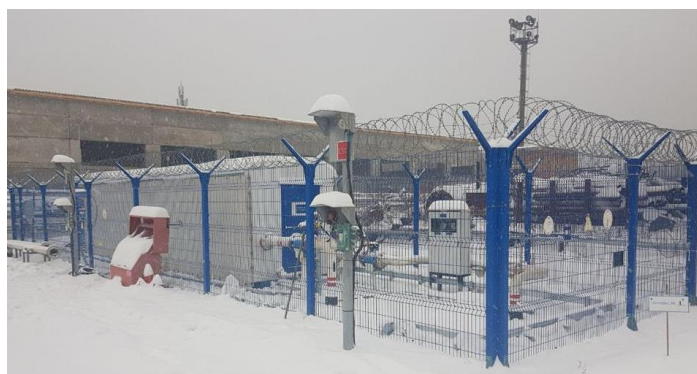
Рисунок 1 - Общий вид СИКН
