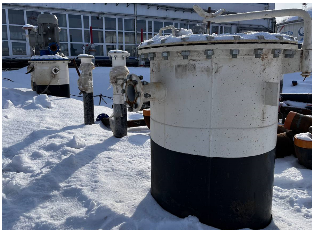
Рисунок 3 – Горловины и измерительный люк резервуара ЕП-40-2400-1500-А-СО-У1 зав.№ 6954
