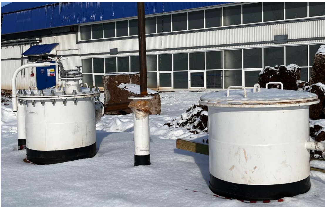
Рисунок 3 – Горловины и измерительный люк резервуара ЕП-25-2400-1100-А-СО-УХЛ1 зав.№ 325
